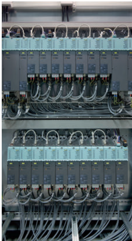
In den elektrischen Schaltschränken dominieren Module der Sinamics S120-Antriebe.
